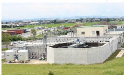
工場 排水処理施設
